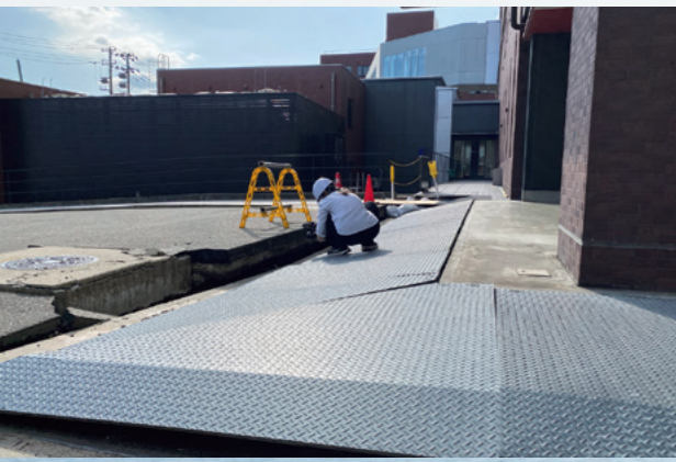
本館の建物は無傷だったが、敷地内には地盤沈下による段差が生じた
