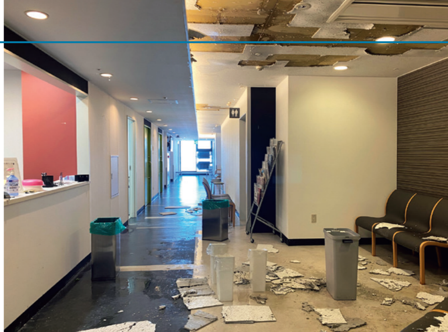
天井の崩落や水道管の破損など甚大な被害が出た3病棟
